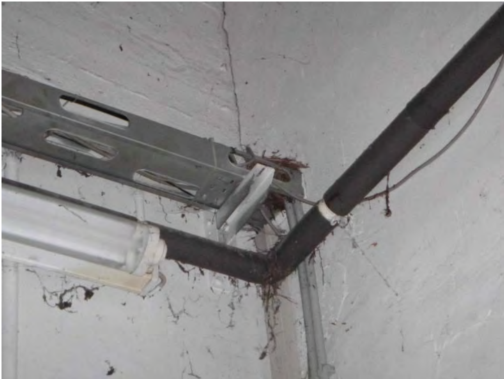
Foto 15: Allerdings wurden an mehreren Stellen Nester vorgefunden, die zeigten, dass Singvögel in das Innere des Gebäudes gelangen. Daher ist das Gebäude vor dem Abbruch auf aktuelle Brutgeschehen zu kontrollieren, sofern der Abbruch in der Brutzeit (01.03. bis 30.09.) durchgeführt wird.
